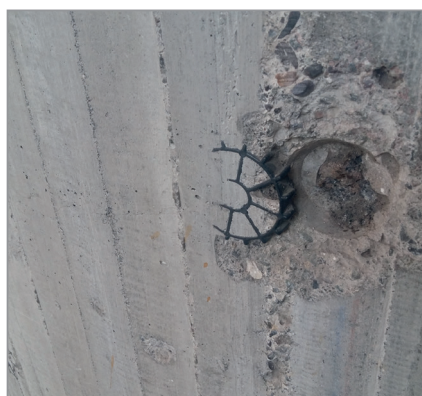
INSTALACIÓN INCORRECTA DE SEPARADOR DE ENFIERRADURA
