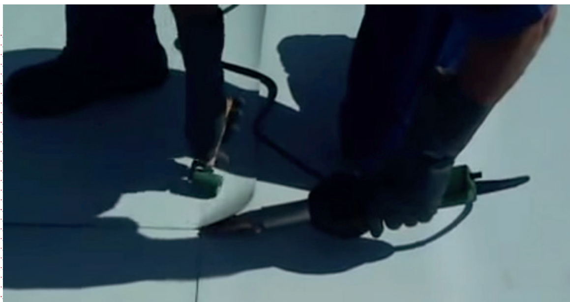
IMPERMEABILIZACIÓN CON MEMBRANA DE PVC
