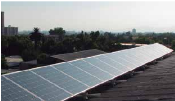
FIGURA 1.23 Generador Fotovoltaico. La imagen corresponde al generador fotovoltaico ubicado en la Universidad Tecnológica Metropolitana, Santiago de Chile, conformado por 21 módulos, con una potencia pico de 4,1 kWp. Fuente: Proteinlab UTEM.
