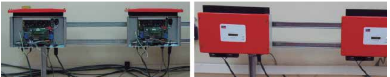
FIGURA 3.10 Instalación y Conexión del Inversor. Se aprecia la distancia entre cada inversor, para una correcta ventilación. Fuente: Proyecto de Generación Fotovoltaica Chilectra-UTEM.
