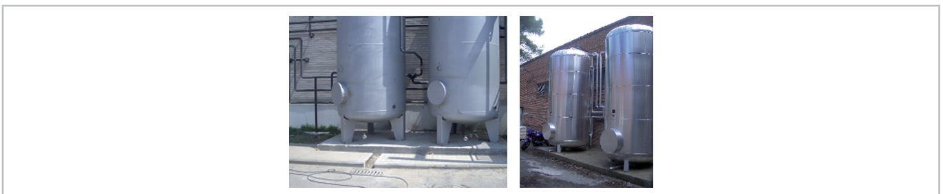
FIGURA 8-10 EJEMPLOS DE ACUMULADORES SITUADOS EN EL EXTERIOR DE EDIFICIOS
