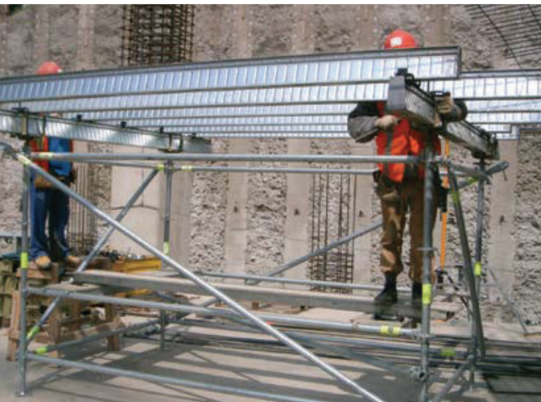
Instalación de un sistema móvil que permite el montaje rápido del encofrado para hormigonar losas y desplazarse en el interior de la obra. (Ulma)
