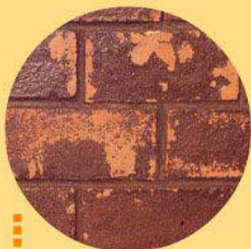
Ladrillo sin protección
